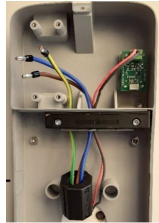
Ferrit-Installation mit Kartenanschlusskabeln mit optoMOS
